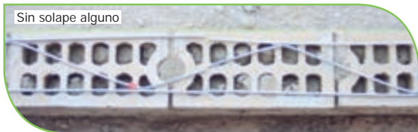
Solape superponiendo armaduras: sin recubrimiento
